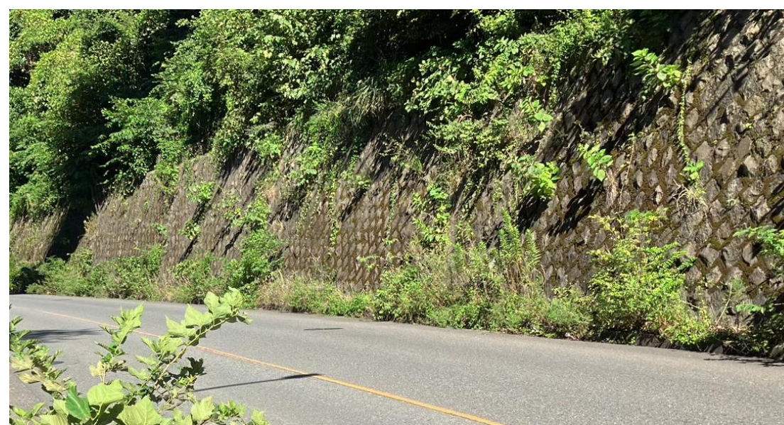
防災まち歩きの際に話題になった擁壁 草木の侵食により劣化が生じている
